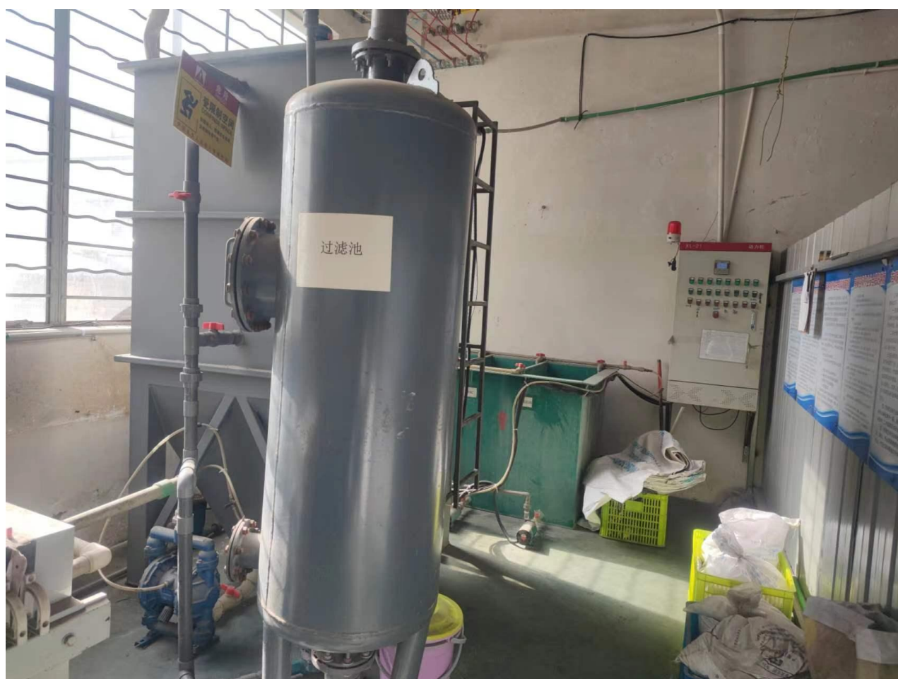
废水处理设施
