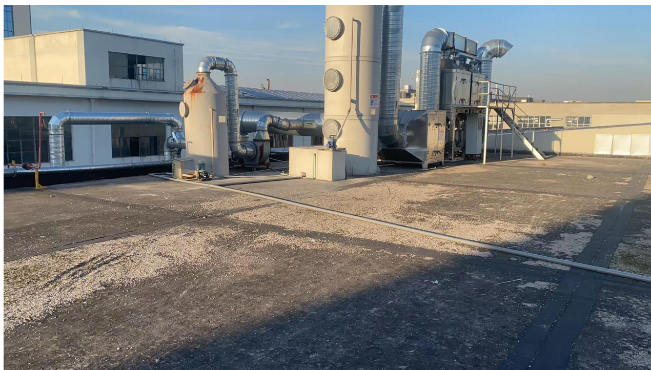
旋流喷淋塔+干式过滤器+活性炭吸附浓缩+脱附催化燃烧装置
